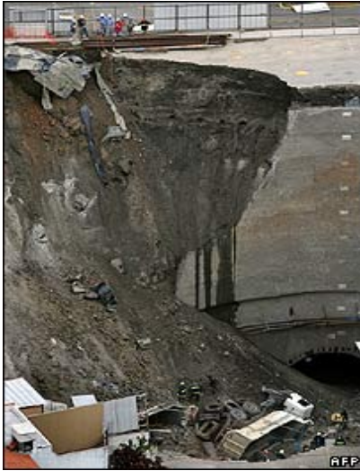
Hình 2. Đường hầm đào để xây ga tàu điện ngầm bị sập ở Sao Paulo, Brazil [11].
