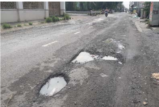
Hình 1. Hiện trạng tuyến đường Dương Đình Cúc, huyện Bình Chánh, TP.HCM.
