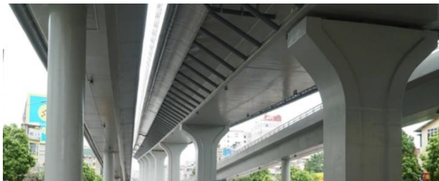
Hình 1. Thanh chống thép tăng khả năng chịu lực cho bản cánh dầm hộp trên đường Trường Chinh, tuyến Vành Đai 2, thành phố Hà Nội.
