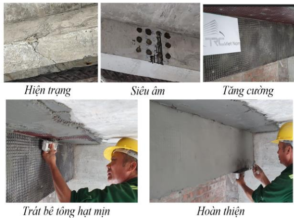
Hình 1. Tăng cường kết cấu dầm BTCT của công trình nhà dân dụng.
