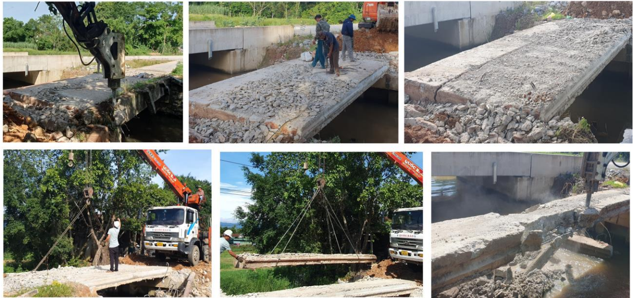
Hình 2. Quá trình tháo dỡ và thu hồi dầm bản của cầu Bến Chợ.
